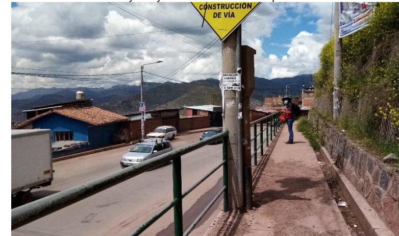
Imagen N° 101: Poste de alumbrado público instalado en la mitad de la acera, disminuyendo y obstaculizando el tránsito peatonal.
